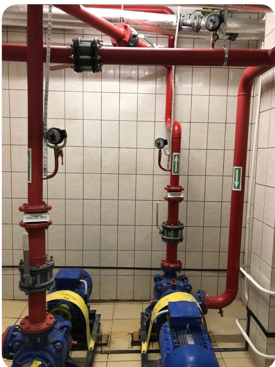
ИНДИВИДУАЛЬНЫЙ ТЕПЛОВОЙ ПУНКТ
