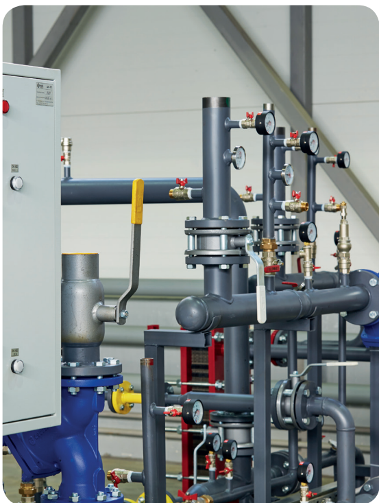
ИНДИВИДУАЛЬНЫЙ ТЕПЛОВОЙ ПУНКТ
